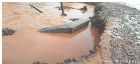
Figura 5 - Ponte de manilha situada no Bairro Água da Areia/ Albanos. O manilhamento do bueiro se rompeu e necessita ser restaurado para possibilitar a passagem sobre o Córrego Água da Areia e permitir o escoamento da produção de 20 (vinte) famílias. Coordenada: -23.431458,-50.242.242309
