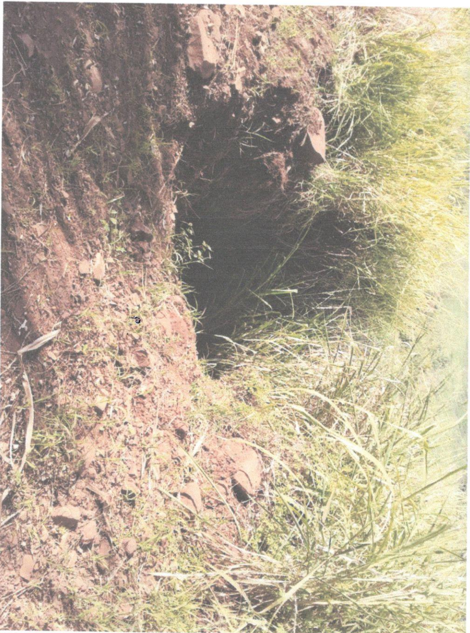
Foto 8- trecho 4.7 - necessidade de instalação de bueiro, e aterramento na margem direita
